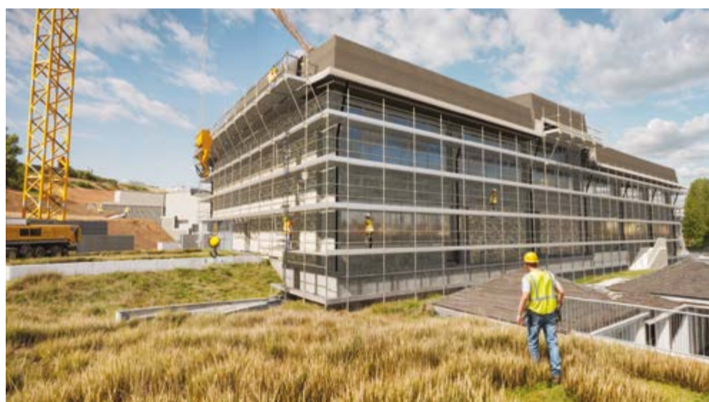
Figura 2. Realizzazione ponteggio di facciata coerentemente allo sviluppo non lineare della facciata e della copertura
