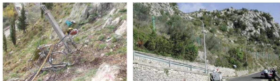
Figura 6. Fronte di roccia e muraglione di contenimento monitorati con sensori a fibre ottiche. Un progetto dell'ing. Diego Dell'Erba con la collaborazione della Sismlab, spin-off dell'Università della Calabria
