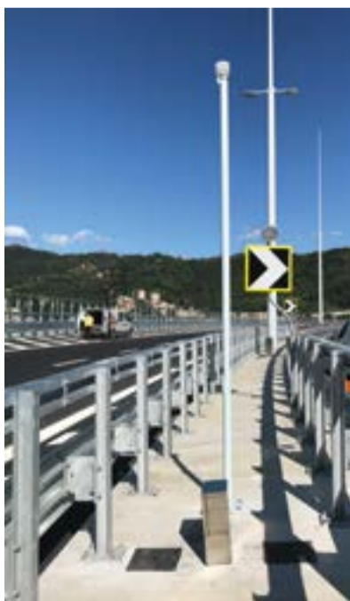
Anemometri a ultrasuoni per misurare l'incidenza del vento, collocati a inizio, fine e metà ponte (immagine fornita da CETENA).
